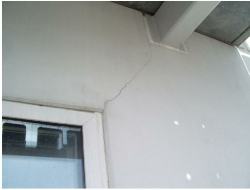
Foto af sandwichforplade med svindrevne over altandør i bolig 10. sal nr. 7.
