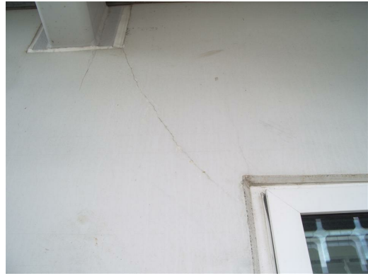
Foto af sandwichforplade med svindrevne over altandør i bolig 7. sal nr. 5.
