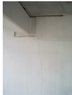
Foto af synlig del af forplade i kælderetage med revne under altan til bolig nr. 2 i stueetagen.
